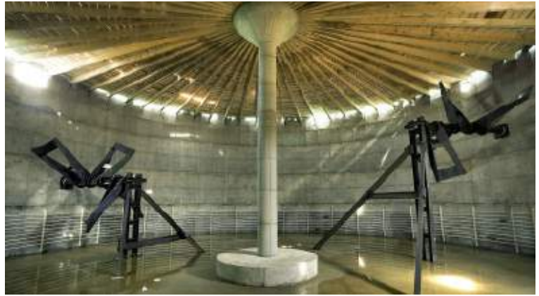
调试前发酵罐的内部
