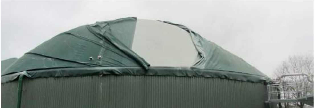
破裂的储气罐示例
